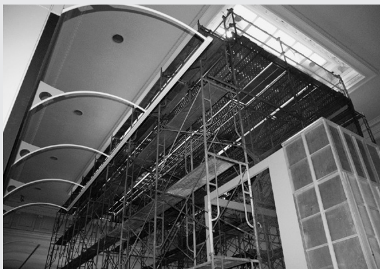
第1室（中央ホール）の工事風景。天井照明改修のための足場が林立している。
