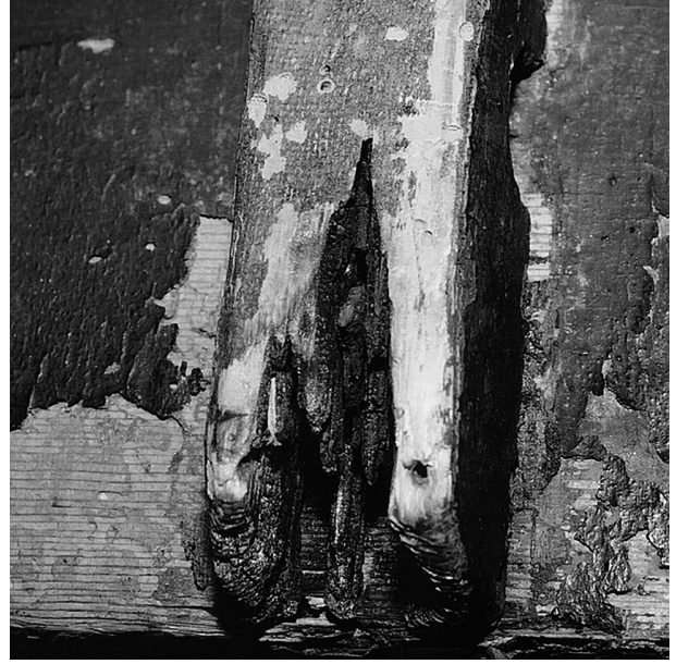
图5 外箱 底面 栈脚 修理前
